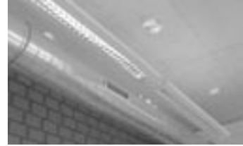
Abb. 4: Abgehängte Deckenleuchten mit Lichtsensorik. Die installierte Leistung beträgt 6,5 W/m 2
