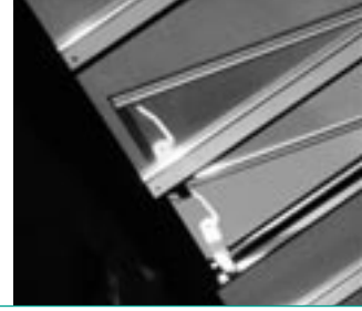
Abb. 8: Öffnbare Oberlichter im Dach des Atriums
